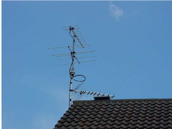
Antenne aan het dak
